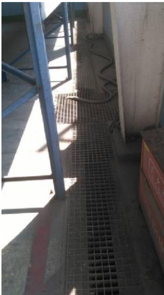
填埋废物堆场内地漏
